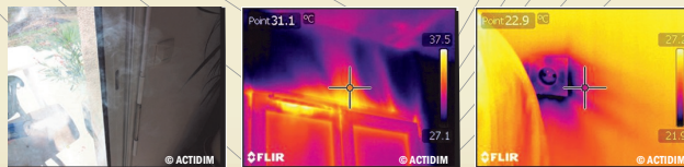
Les fuites sont détectées par anémomètre, fumée ou thermographie
